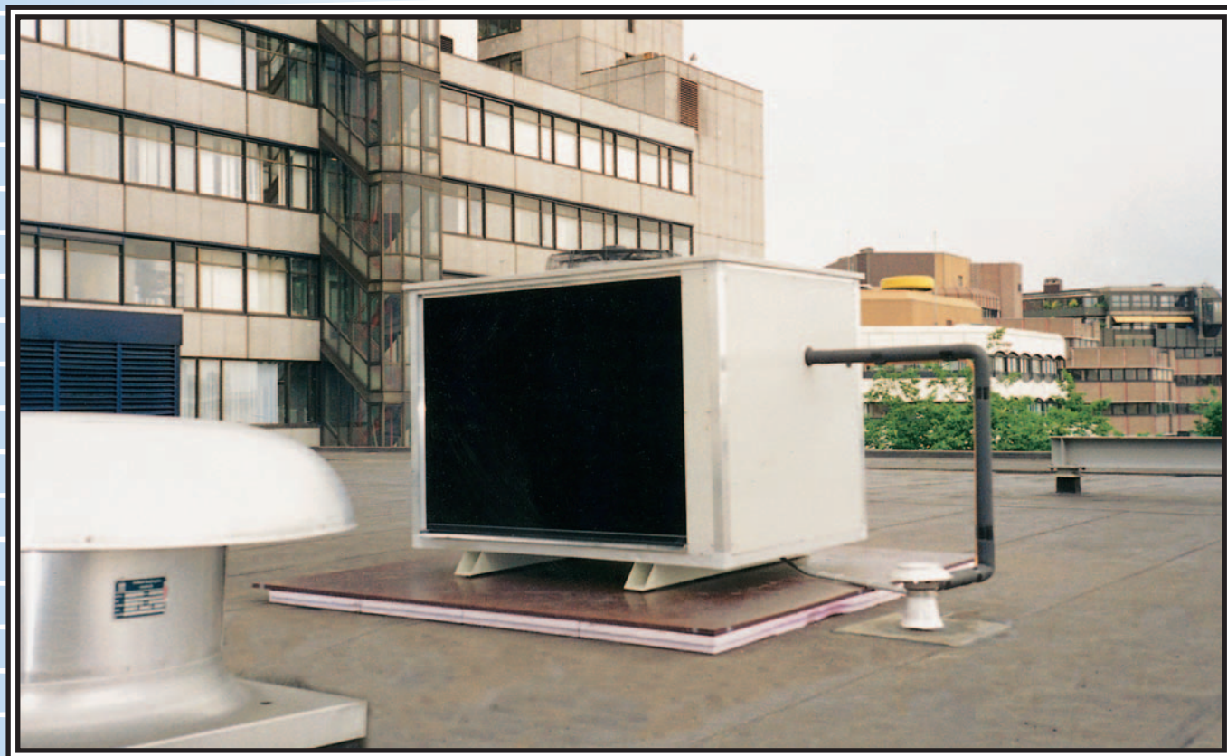
Het exterieur van de directe expansiekoelmachine type BCC10/124-II-1, condensorzijde
