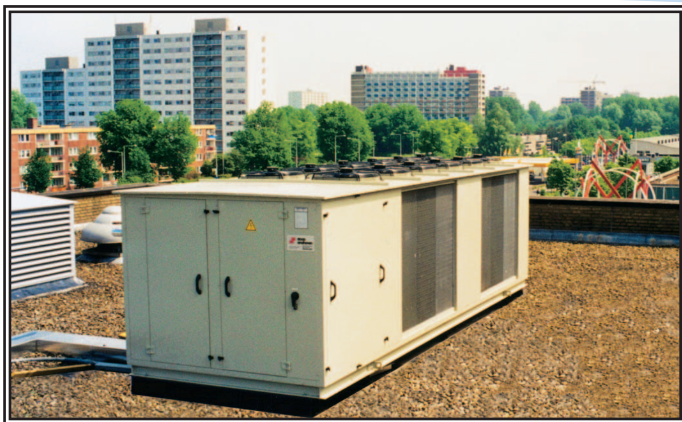
Directe expansiekoelmachine type BCC40/294-III-3; opgesteld bij V&D Amsterdam Noord Gevuld met koudemiddel R407C; in vier trappen geregeld
