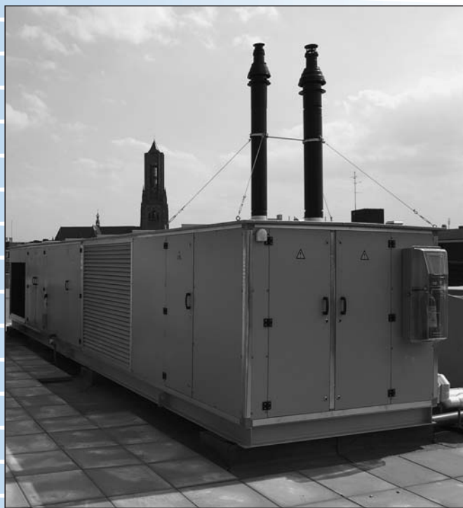
Dakcentrale type BDK20G-III opgesteld bij ZARA te Arnhem met twee HR gaswandketels
