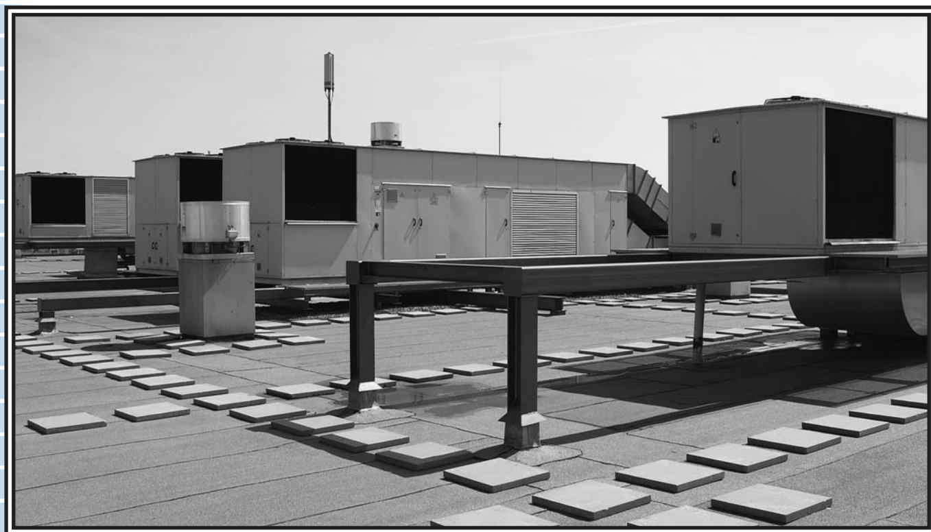
Dakcentrales opgesteld bij V&D Rijswijk, winkelcentrum "in den Boogaard"
