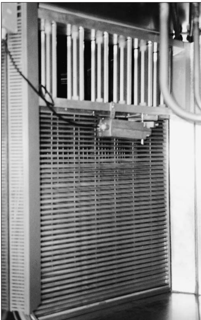
Platenwarmtewisselaar met omloopklep en proportionele servomotor.
