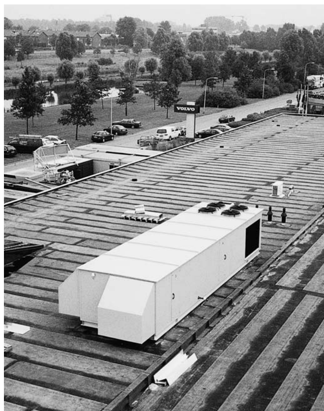
Dakcentrale type BDU 22We, opgesteld bij NIBM te Waddinxveen. Voorzien van een platenwarmtewisselaar.
